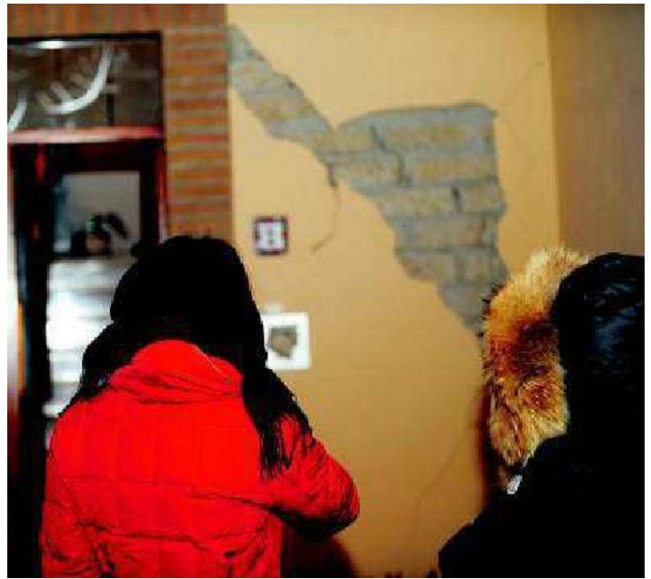
Sisma Un'abitazione di Marsciano lesionata dal sisma del 15 dicembre 2009
